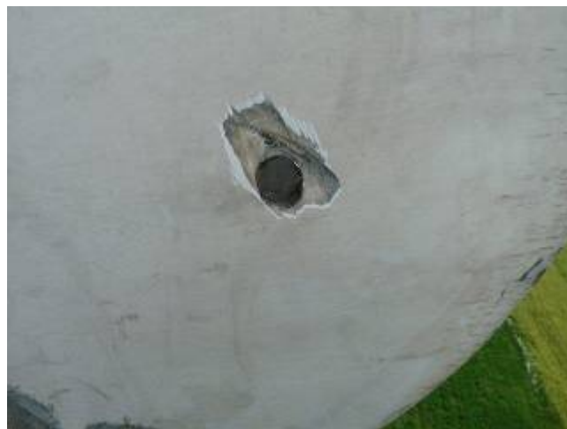
Фиг. 6 Нарушение на обшивката около рецептора
