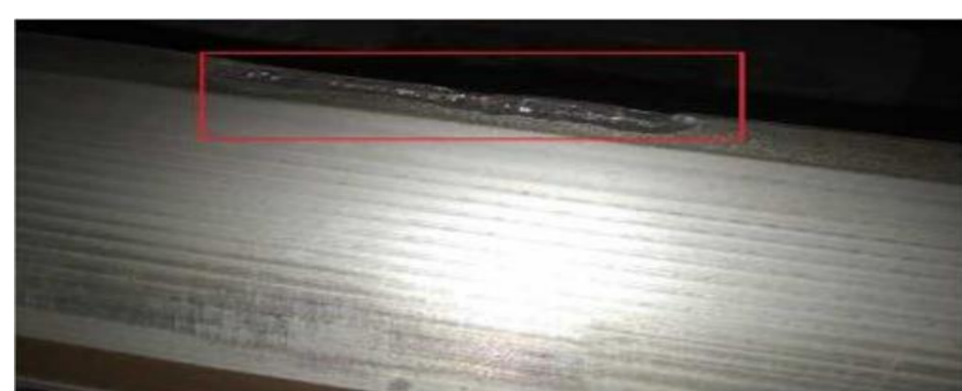
Фиг.2. Дефектирал участък( ограден с червеното поле)
